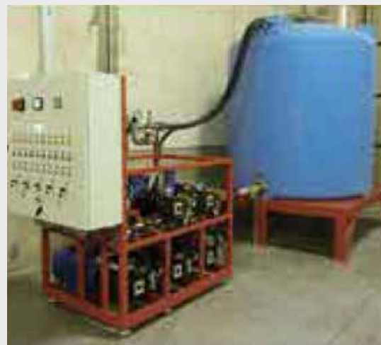
▼ Sistemi ad acqua nebulizzata Water Mist costituiti da gruppi di pompaggio con elettropompe/ motopompe
